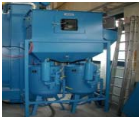
Esempio di serbatoi pneumatici per la raccolta dell'abrasivo
